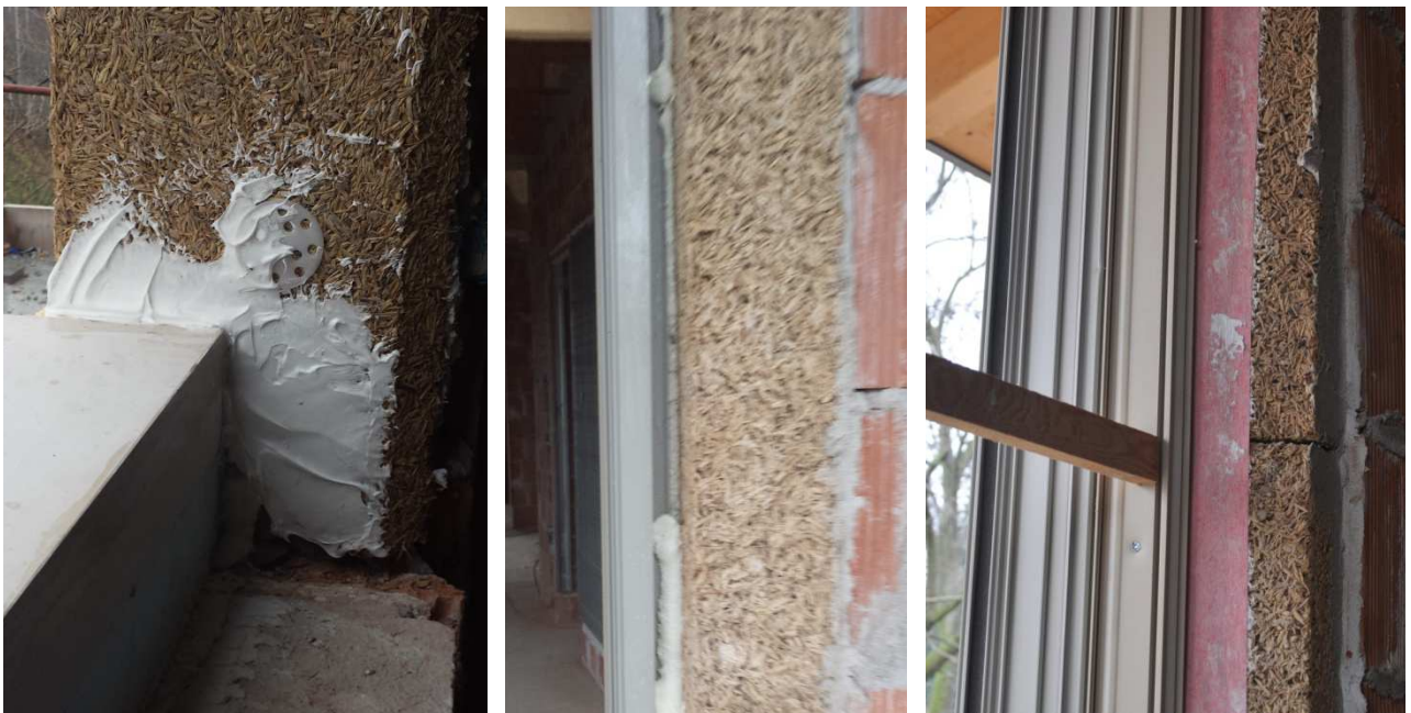
Fase 4: Installazione degli elementi di finitura (ripiani e cassonetti) e posa del telaio.
