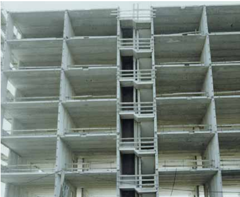
Fig. 1.4 Le pareti alveolari portanti ed i solai alveolari in un edificio residenziale pluripiano
