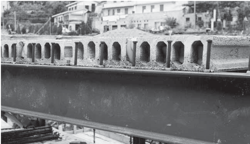
Fig. 4.22 Solai alveolari su travi in acciaio. I connettori a chiodo possono essere saldati per induzione sulla testa della trave anche dopo la posa in opera del solaio.
