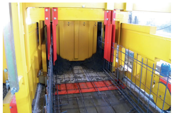
Macchina Vibrofinitrice Nordimpianti durante la fase di getto. In evidenza l'uso simultaneo dell'armatura lenta e precompressa.
