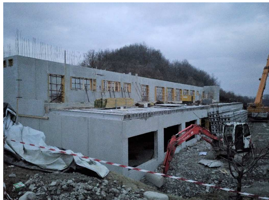
Terminata posa delle pareti perimetrali del primo piano e del primo solaio d'interpiano
